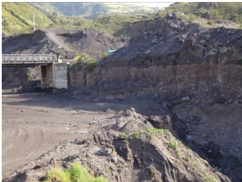
Foto 2. Erosión regresiva bajo el puente de La Pampa ocurrida después del pequeño lahar del día martes 04.
