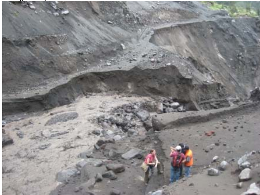
Figura 2: Socavamiento del relleno y destrucción del paso de la quebrada Achupashal debido a los lahares del 5 y 6 de Abril. Foto: C. Viracucha (OVT- EPN)
