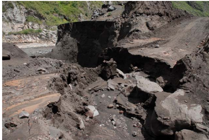
Figura 8: Vía totalmente destruida, Q. Ingapirca. Foto: (Beth Bertel OVT)
