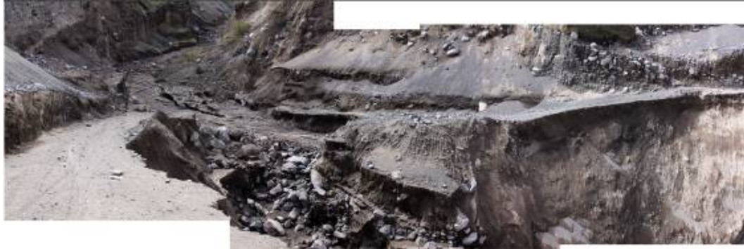
Figura 12: Erosión del cauce de la Q. Achupashal y colapso de la mesa de la carretera en ambas márgenes por efecto de los últimos lahares (Fotos: P. Ramón-OVT/IG)
