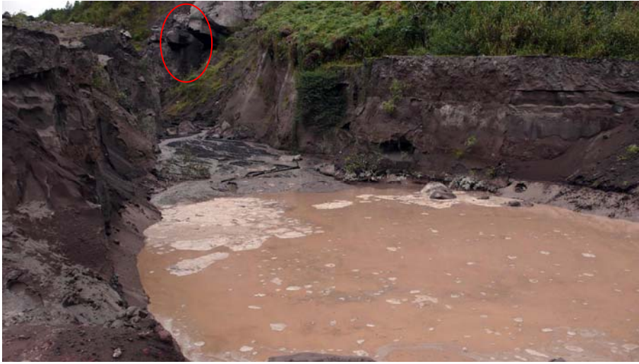
Figura 12: Represamiento de agua en la Q. Chontapamba junto al relleno de la vía.
