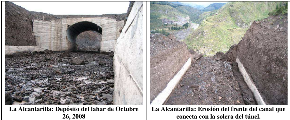
Figura 6: Estado de los lahares en la alcantarilla
