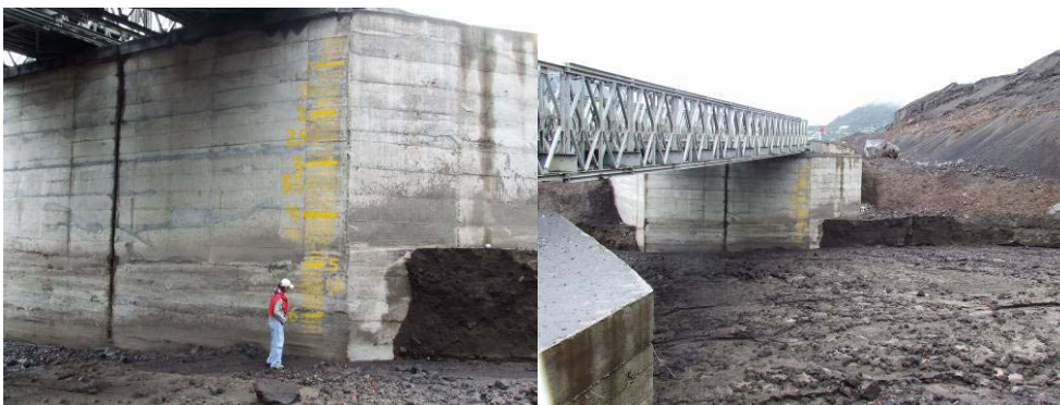
Figura 7. Fotografías del estribo occidental (izquierda) y del estribo oriental (derecha) de l puente del sector de la Pampa en la vía Ambato-Baños, donde se muestran los depósitos del lahar de las 0h30 del 9 de Septiembre del 2008.
