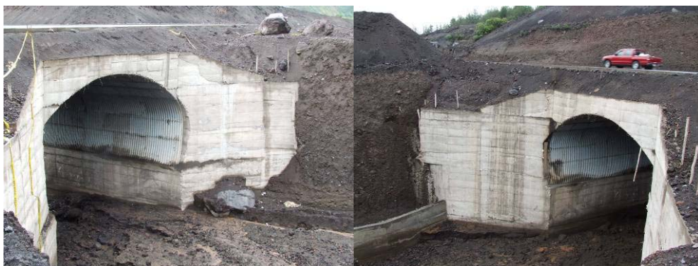
Figura 8. Fotografías de la alcantarilla en el sector de la Pampa con señales del paso del lahar del 9 de Septiembre del 2008
