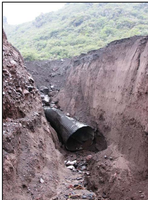
FOTO 1: Parte de la alcantarilla colapsada (3m de diámetro) por el descenso de lahares en el sector de Juive-La Pampa. Nótese la erosión producida por el flujo. (Foto: J. Bustillos)
