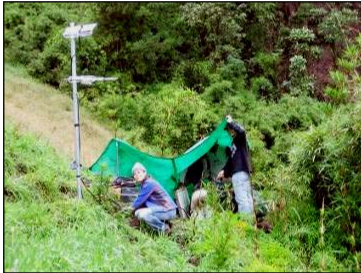
Foto 5. Trabajos de instalación de la nueva estación sísmica Juive-6 (782524 / 98942742) (Foto: J Bustillos)
