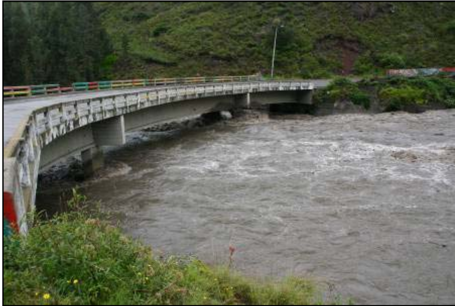
Foto 3. El Río Chambo completamente crecido. Nótese el nivel de agua con relación al puente, sector Penipe carretera a Riobamba (Foto: P. Ramón)
